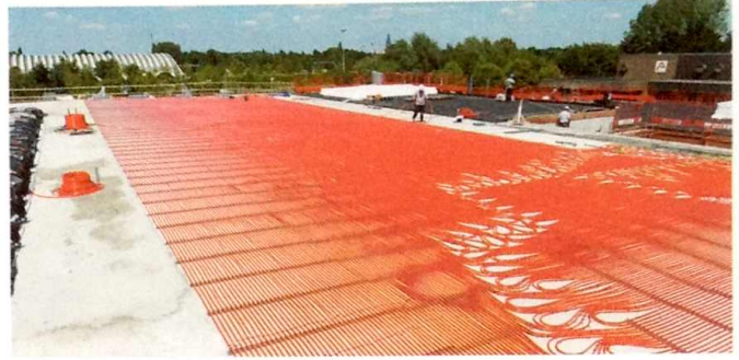
1300m 2 dak is ontworpen als geïntegreerde zonnecollector.
